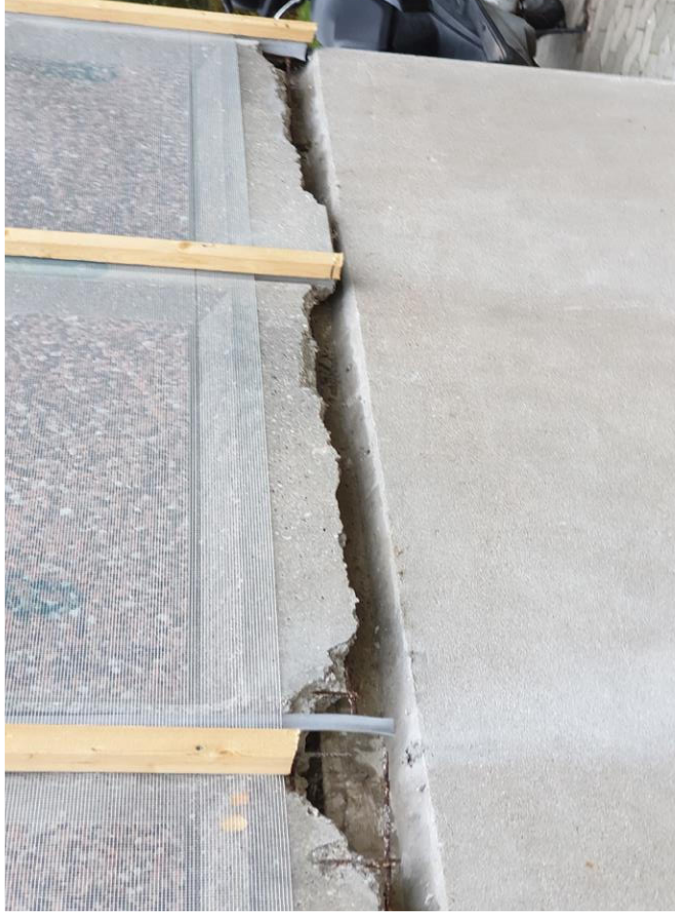
Afbrækket beton i gavl
